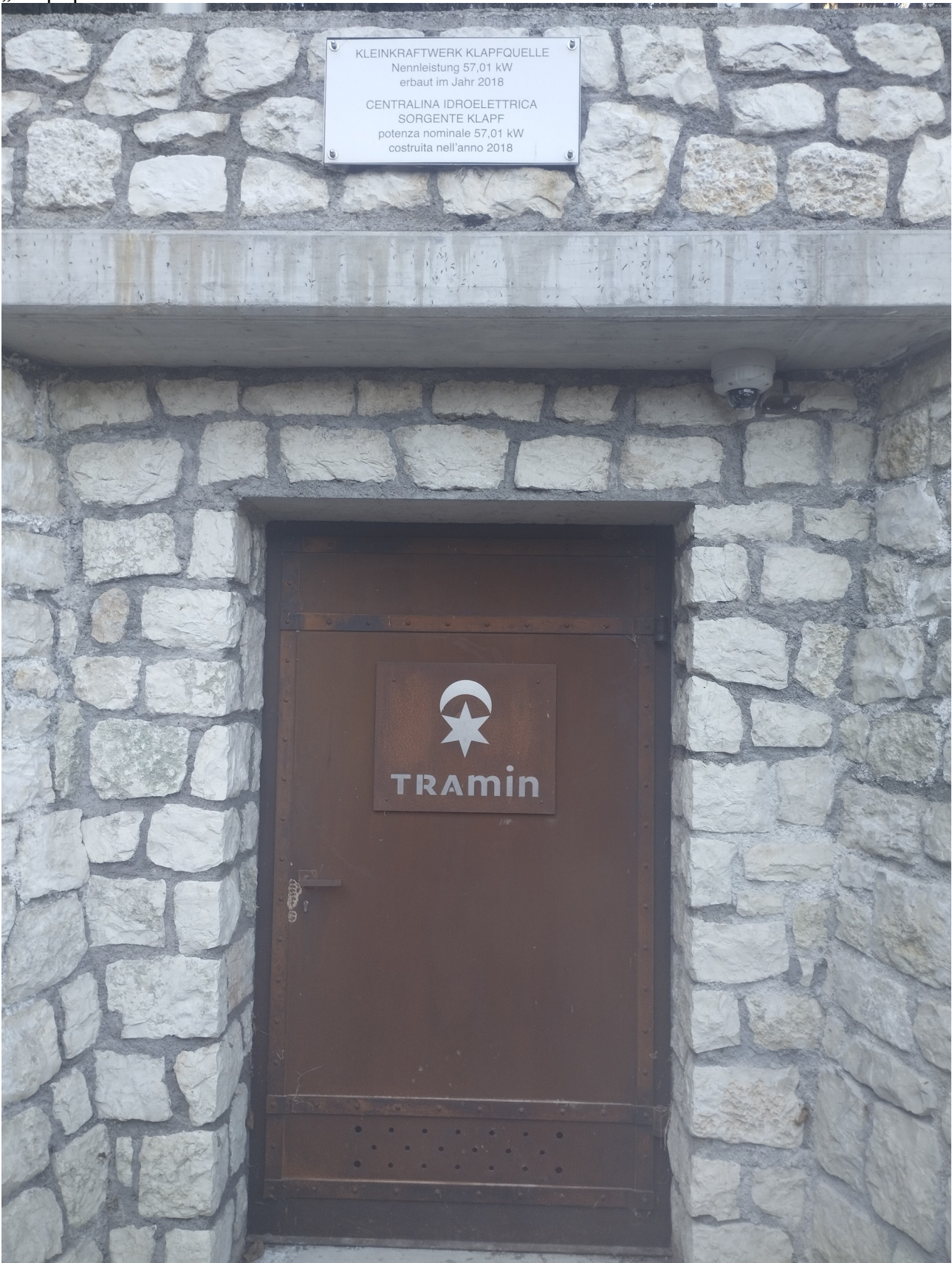
Abb.3 Tür mit Überwachungskamera Kleinkraftwerk „Klapfquelle“ Immagine 3 Porta con telecamera di sorveglianza centrale elettrica di piccola dimensione „Klapfquelle“
